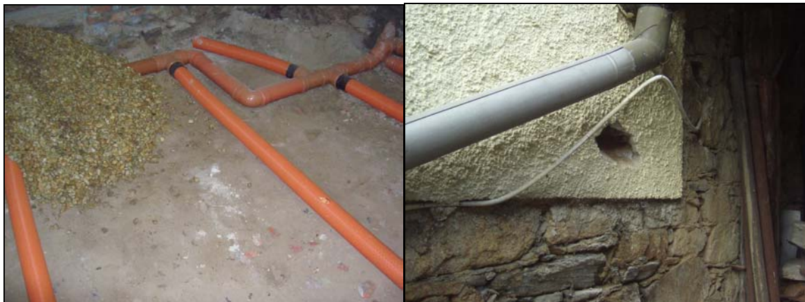
Abb. 11: Luftdrainage im Erdgeschoss und Frischluft-Ansaugöffnung
